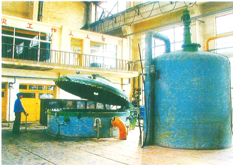
图03真空压力浸渍设备
